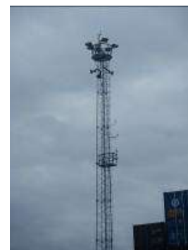
Figure 6.1 Torre de iluminación
