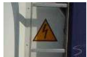
Figura 8.5 Advertencia de peligros en el techo
